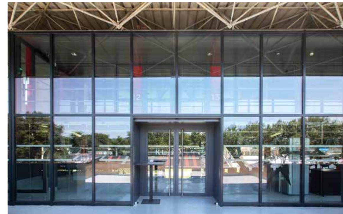
Façade vitrée composée d'une porte d'accès acier intégrée dans un mur rideau périphérique
