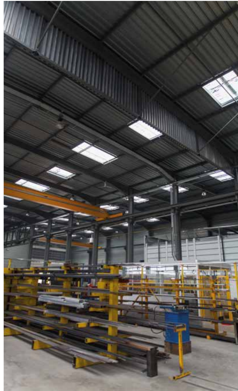
Charpente couverture bardage métallique • Ecrans de cantonnement – Puits de lumière et désenfumage
